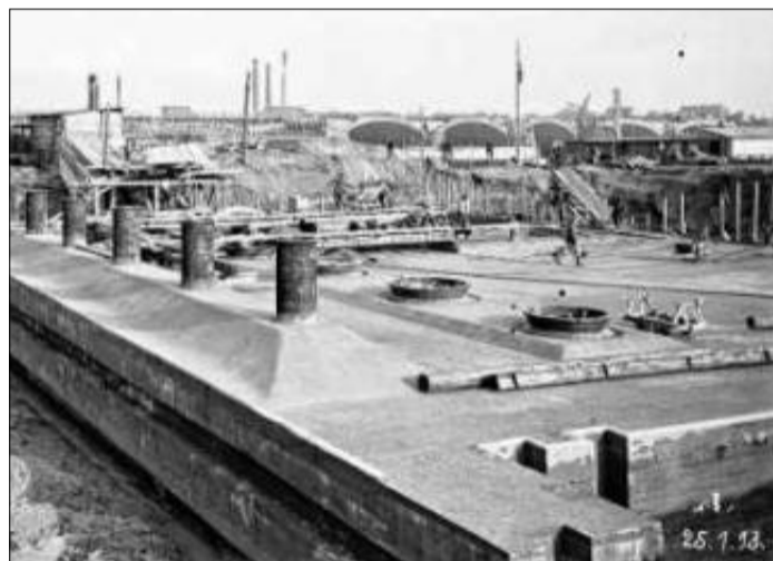
Halbzeit: Nach zwei Jahren Bauzeit waren im Januar 1913 über den Unterbau des Pumpwerks hinweg bereits die Bögen der Kanalüberführung in der Ferne deutlich zu sehen.
