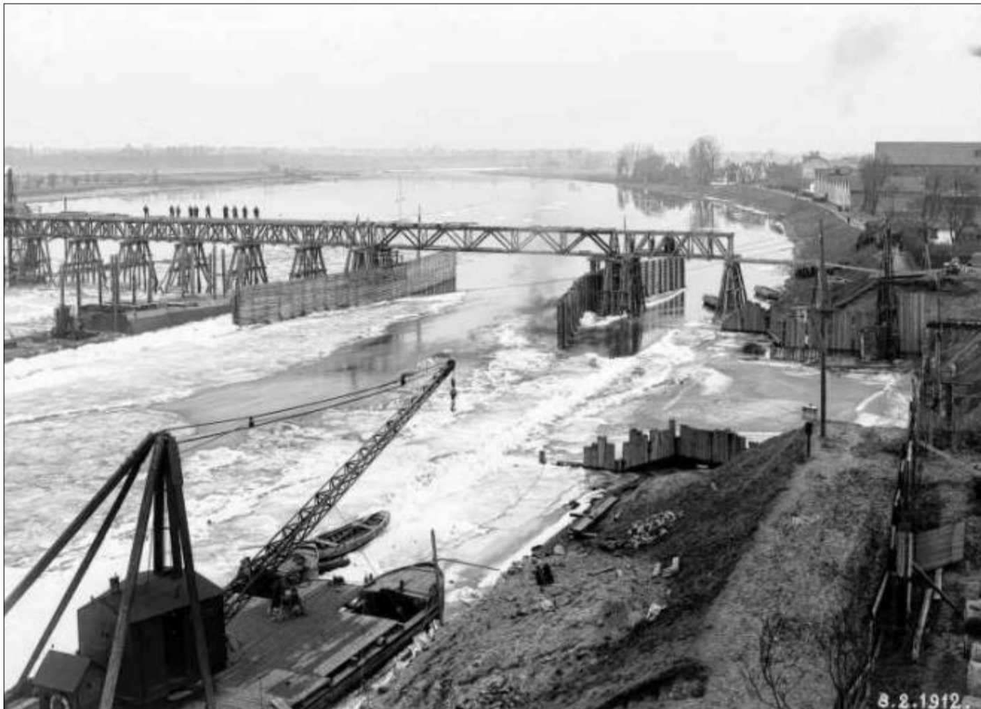
Erschwerte Bedingungen: Im Februar 1912 gefährdete Eisgang auf der Weser die im Vorjahr begonnenen Arbeiten.
