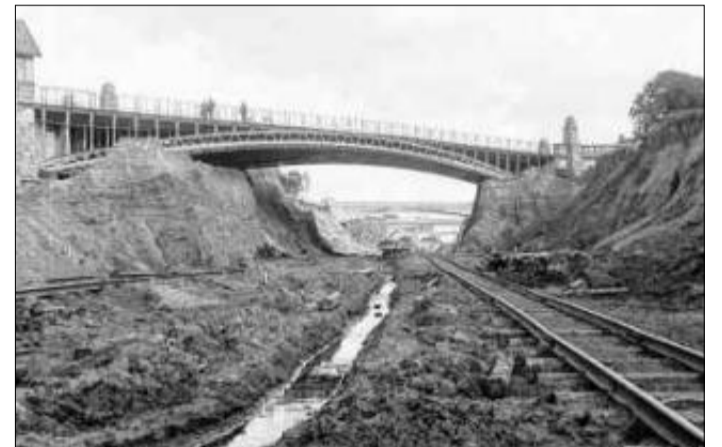
Vier in kurzer Folge: Auf der Stadtstrecke waren viele Brücken wie 1913 für die Stiftsallee (im Vordergrund) zu bauen.
