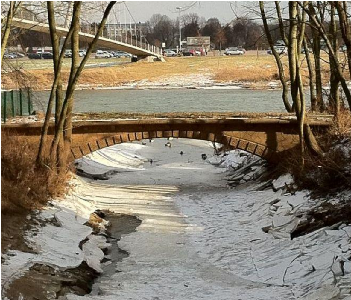
Foto: Gesperrte Bastau-Brücke im Bereich der Weserpromenade Minden.
