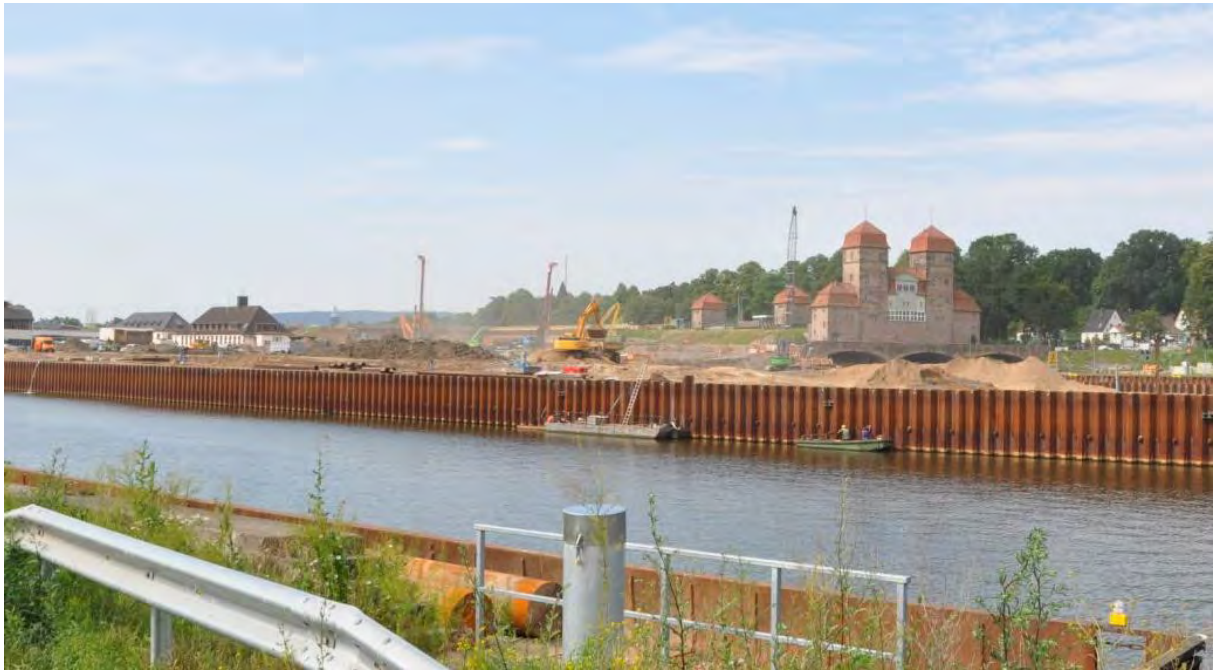
Foto: Schleusenbaustelle am Wasserstraßenkreuz Minden mit der bestehenden Schachtschleuse im Hintergrund (6. Juli 2011).
