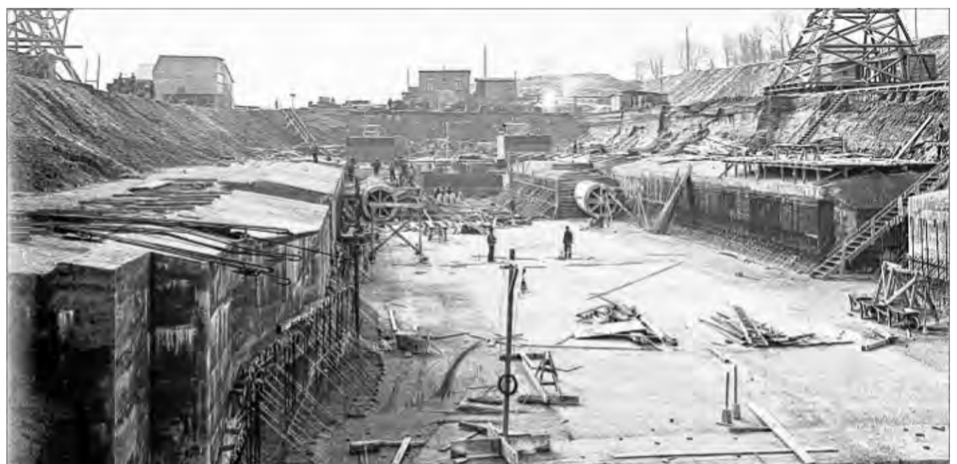
Frühes Stadium: In der Baugrube, die von zwei Kränen überspannt wird, laufen im März 1912 die Schalungsarbeiten für die Kammerwände und die Umläufe, die im hinteren Teil bereits deutlich zu erkennen sind.
