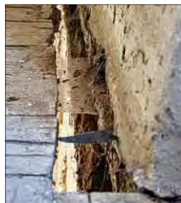
Zwischen Giebelwand und Fußboden klafft ein Spalt.
