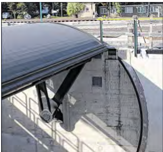
Das Drehsegmenttor an der Kanalseite ist betriebsbereit. MT-Fotos: Alex Lehn
