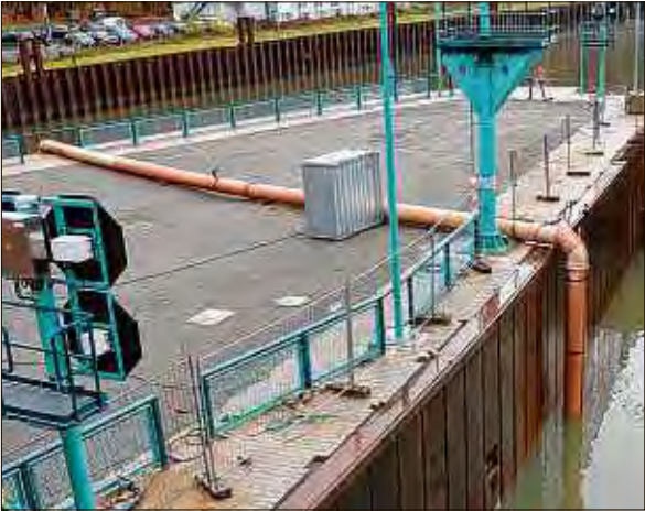
900er-Rohr: Über eine Rohrleitung fließt Weserwasser in das Vorbecken.
