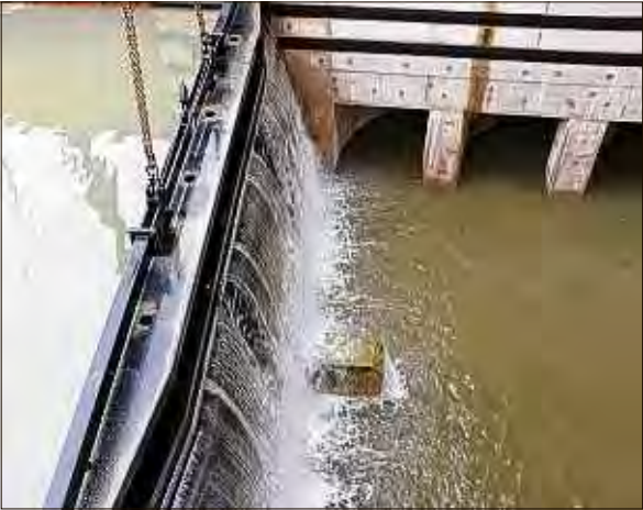
Allmähliche Flutung: Das einströmende Wasser fließt durch die Zuläufe in den Grundlauf.
