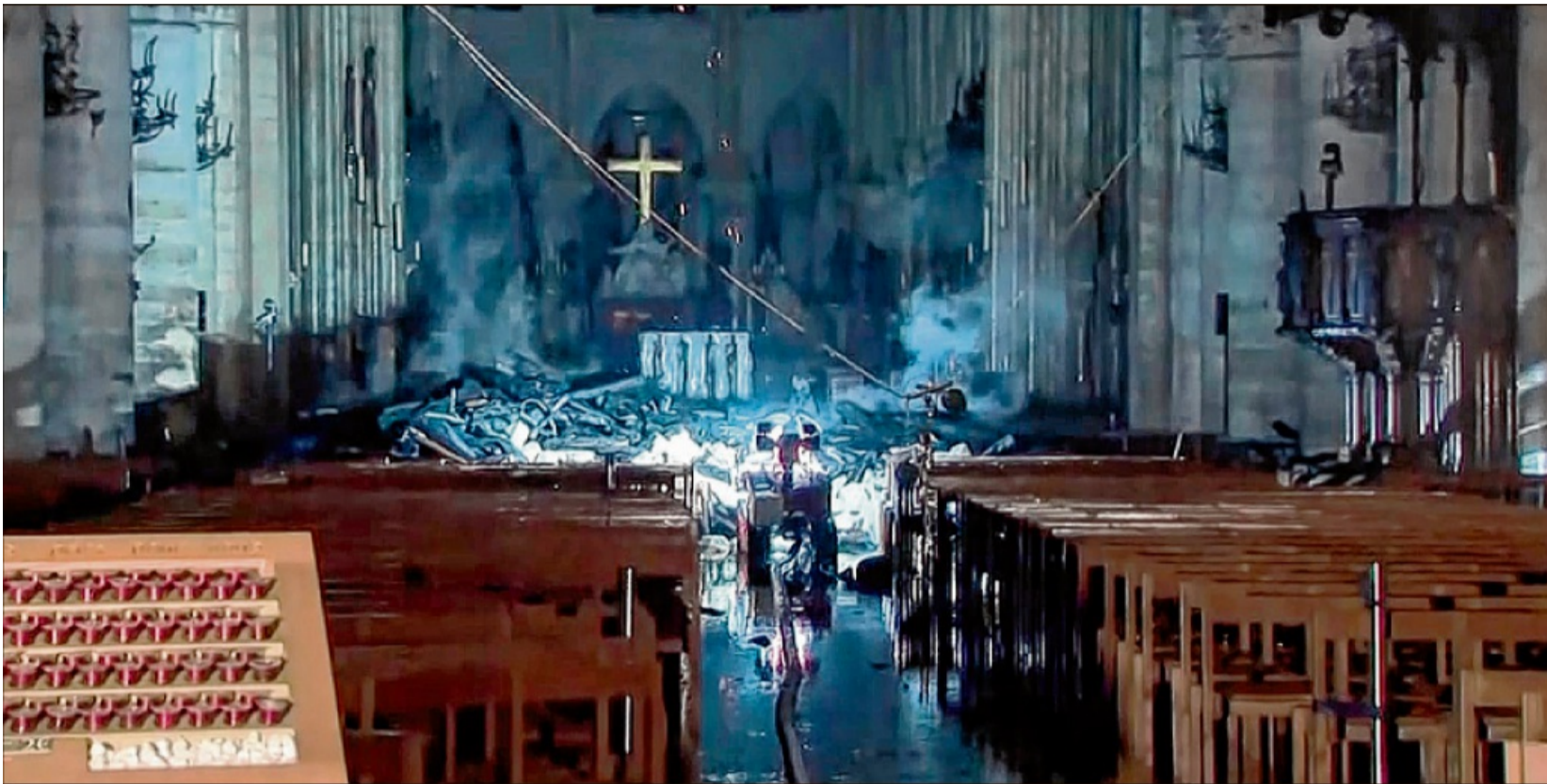
Dieses Videostandbild des französischen Fernsehsenders France Televisions zeigt einen Brandschaden in der Kathedrale Notre-Dame. Nach dem verheerenden Brand sind die Flammen komplett gelöscht. Foto: Uncredited/France Televisions/AP/dpa
